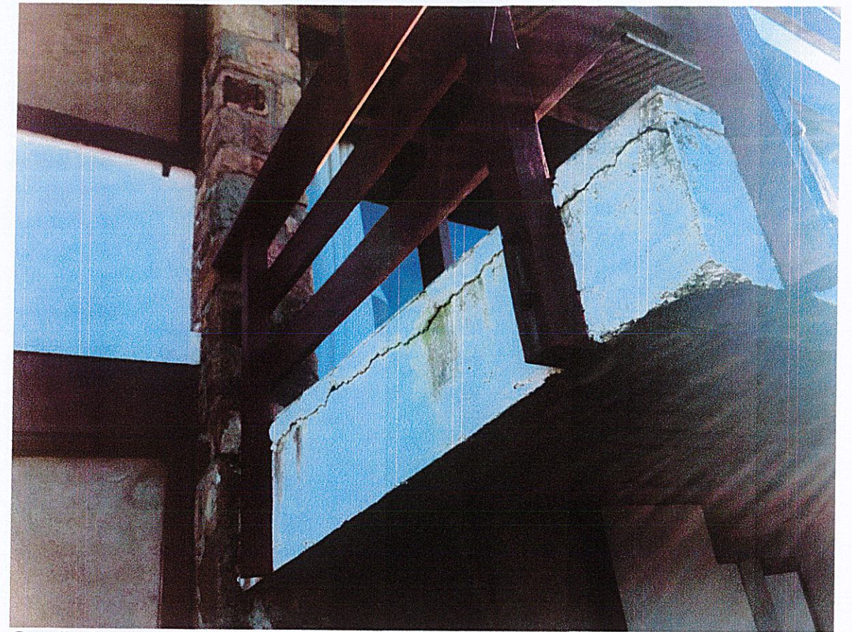
On distingue sur cette photo la fissure horizontale entre la chape et la dalle de la terrasse.
