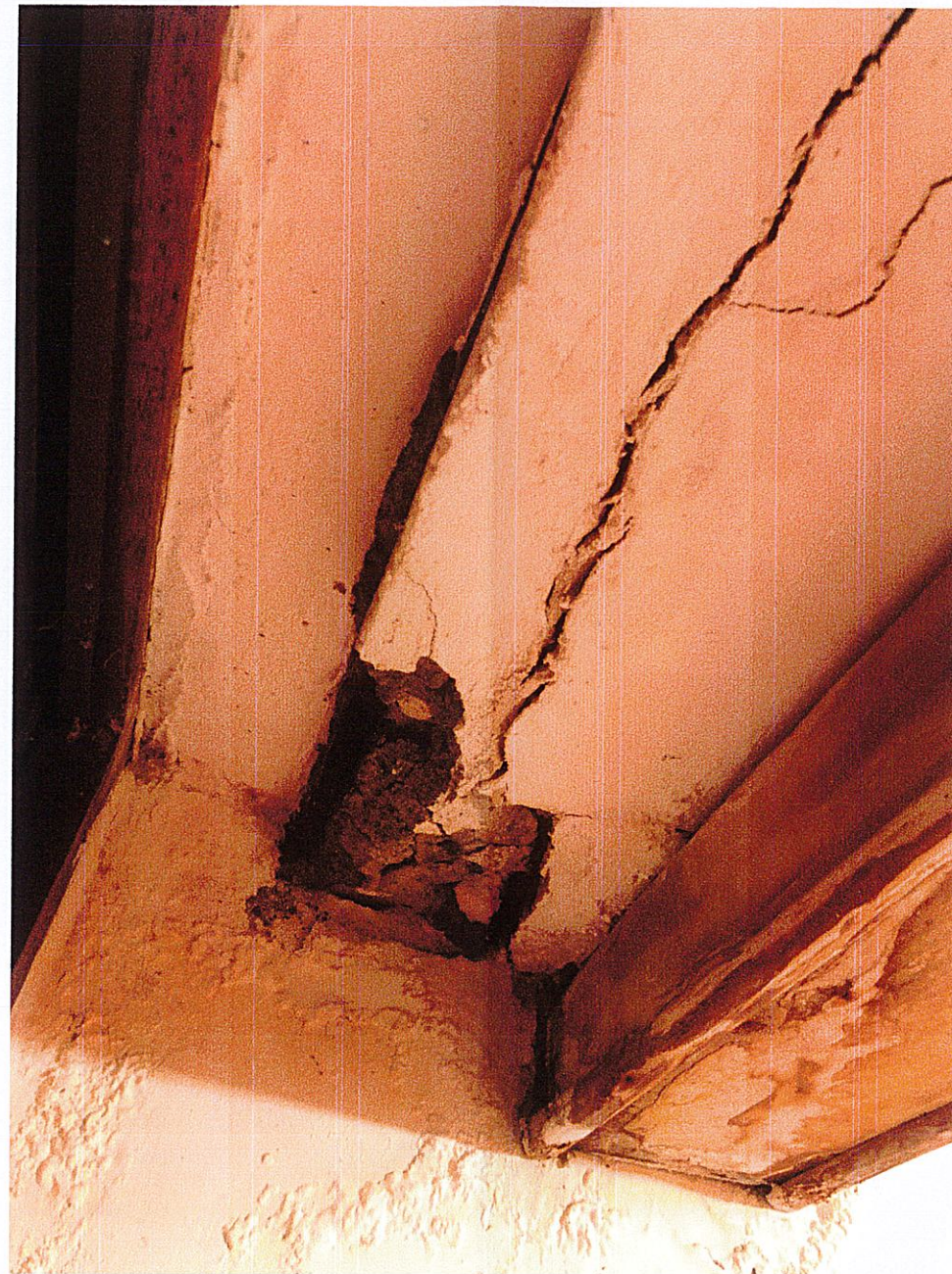
Détérioration dangereuse des linteaux de l'étage inférieur.
