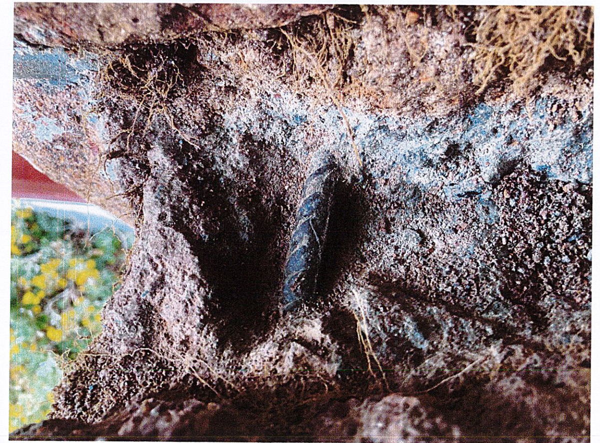
Le sondage a révélé le faible ferrailage des consoles de la terrasse.
