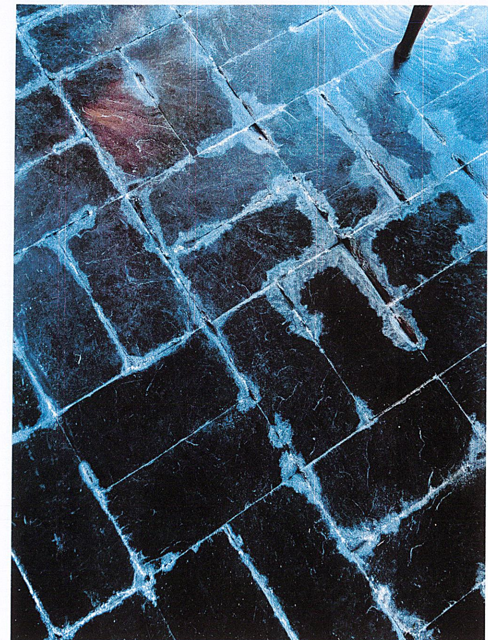
Salpêtre s'immissant sous les dalles ardoisées du séjour à l'intérieur de la maison
