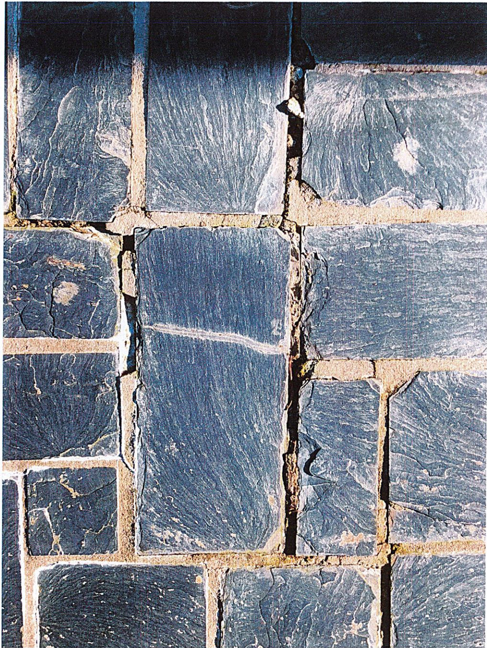
Fissuration du dallage de la terrasse
